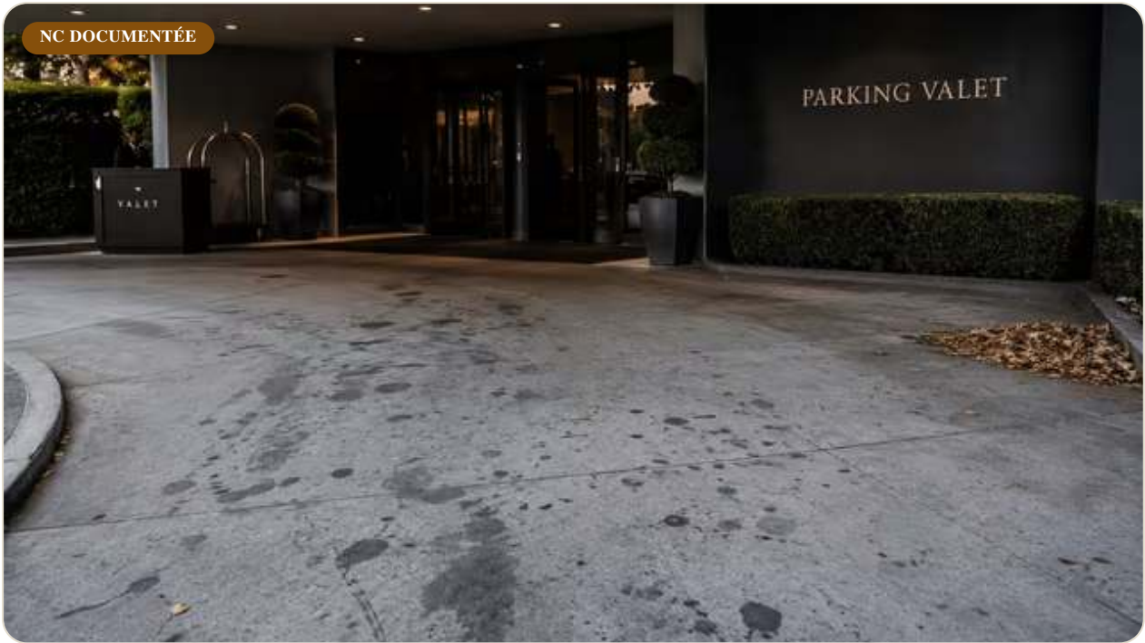
Cadragre : plan large de la zone de manœuvre, taches d'huile visibles au sol béton, feuilles accumulées en angle.
