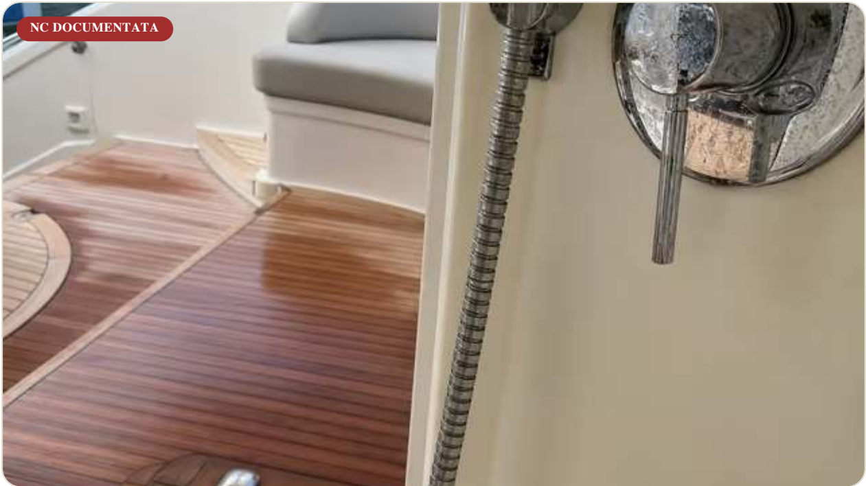
Inquadratura: primo piano rubinetteria + pavimento, rivela il deposito calcareo visibile a 2 metri dalla banchina.
